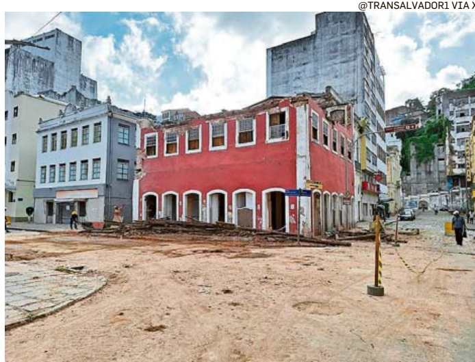
O casarão estava interditado pela Defesa Civil desde 2020
